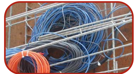
Système de MÉS du garage Laurier-Taché, Hull, Qc
